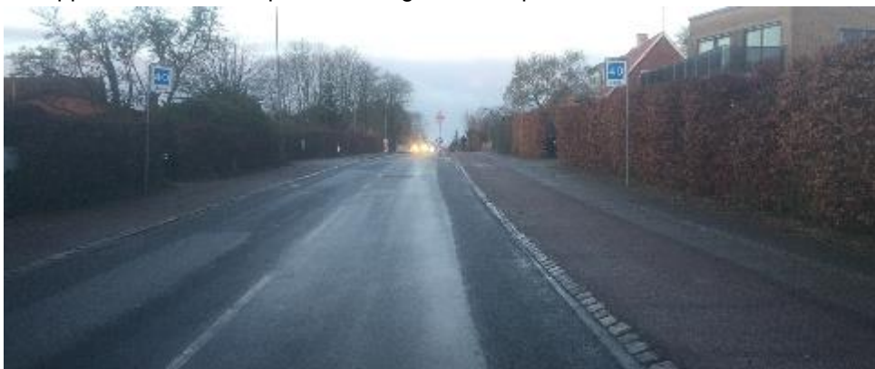
Figur 1 - foto fra besigtigelse.
